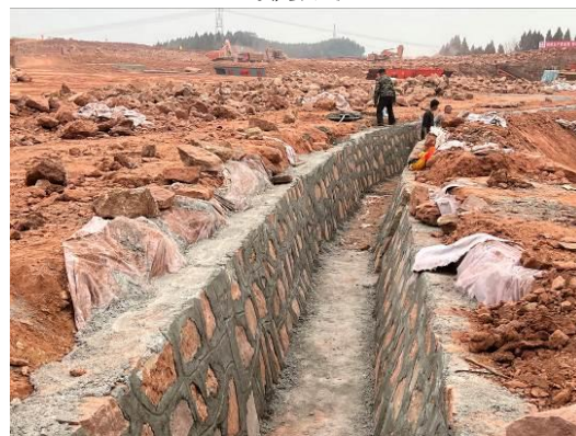
服务区排水沟
