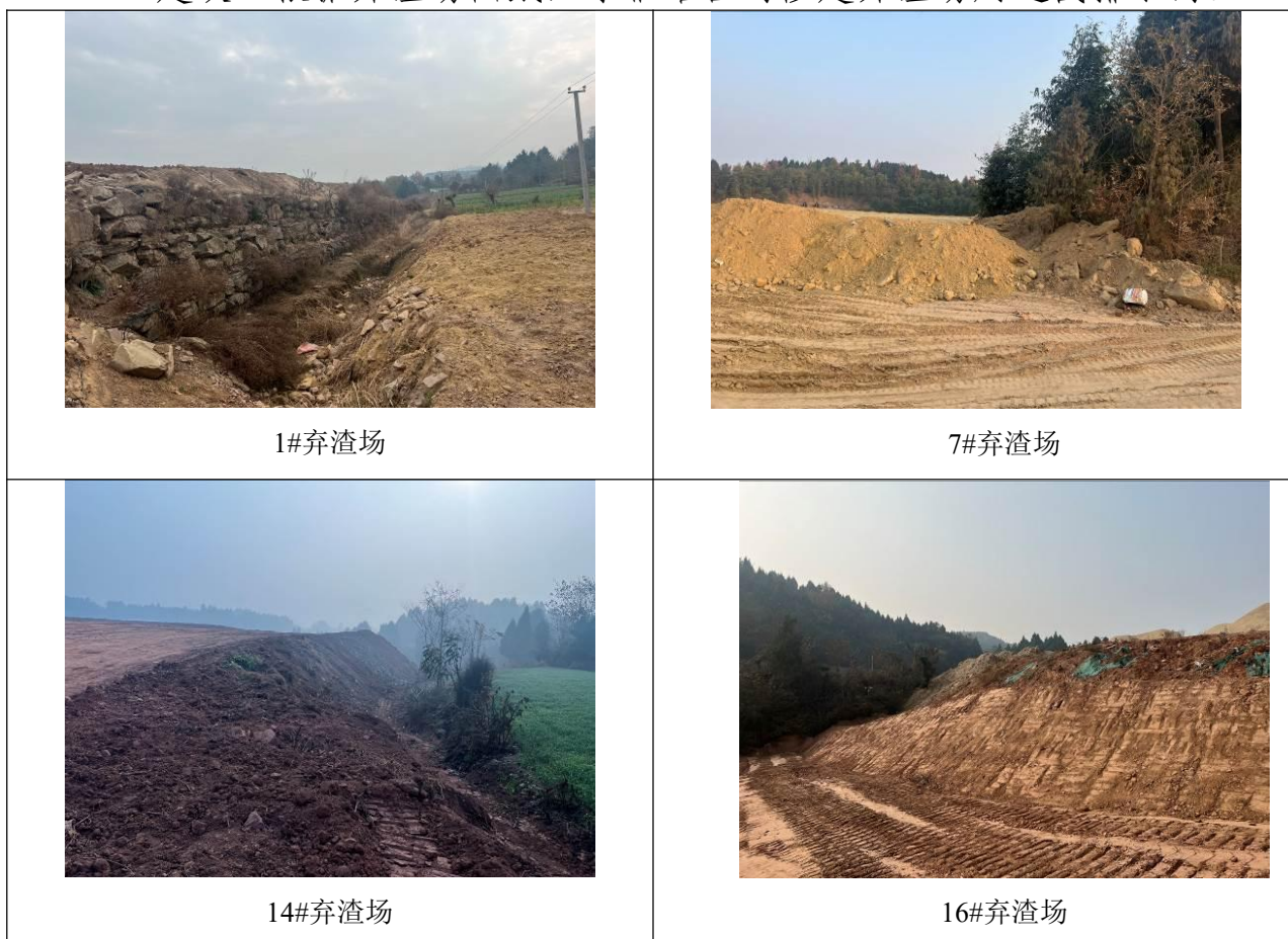
图 5-3 弃渣场周末截排水措施不完善
