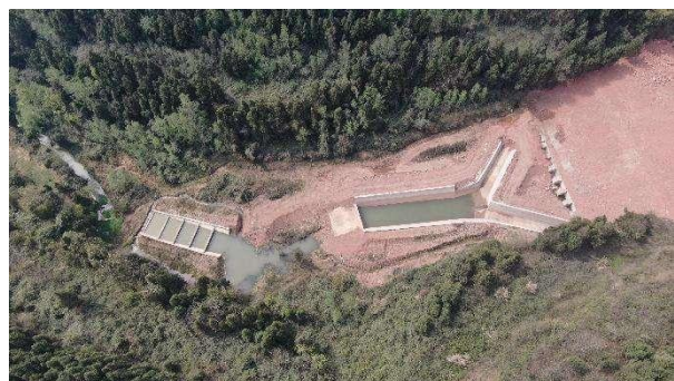
弃渣场消力池及沉砂池
