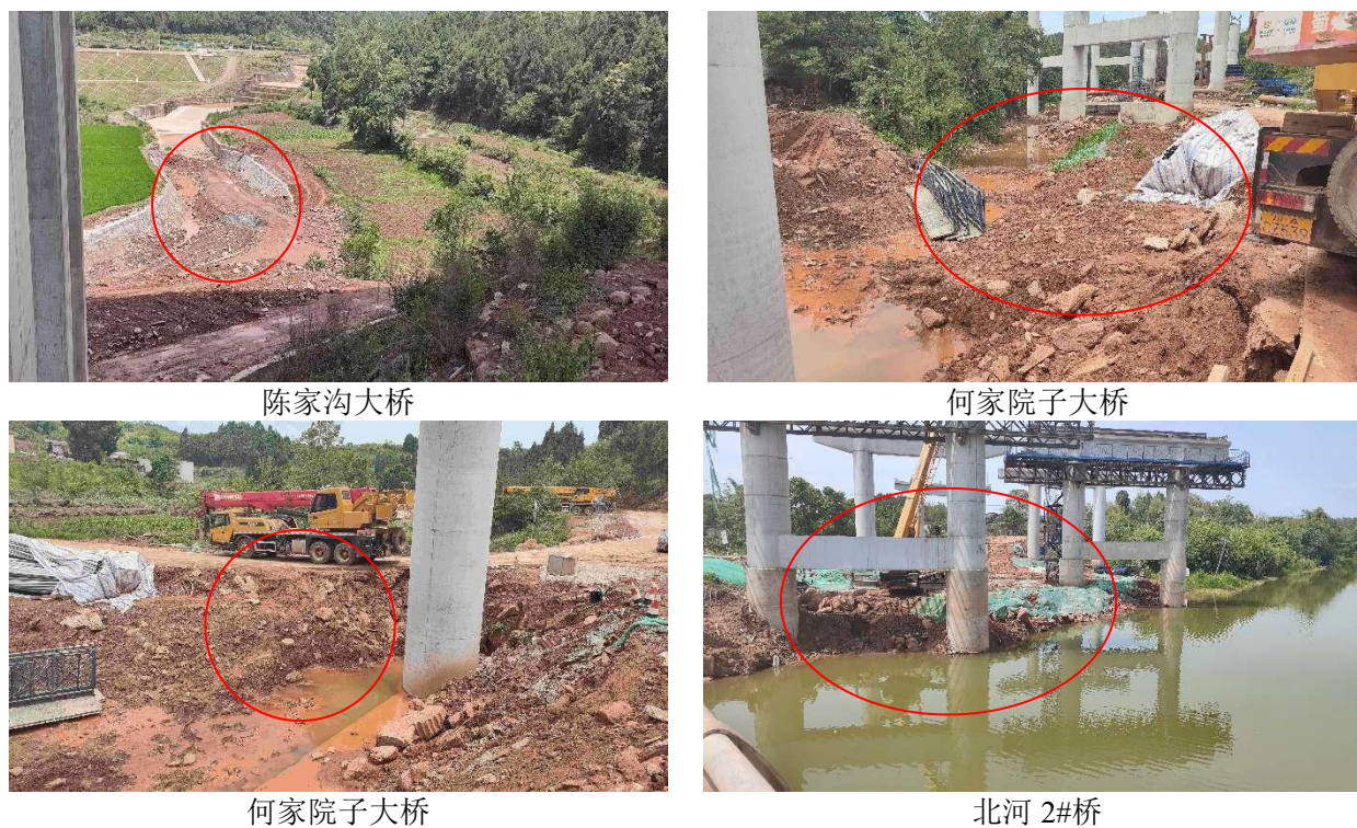
图 5-4 侵占沟道区域
