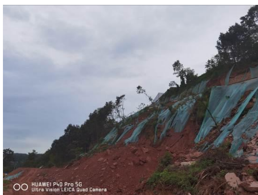
3-1 标段金竹沟大桥密目网破损
