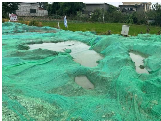
5 标段北河 1 号桥施工场地内无排水措施
