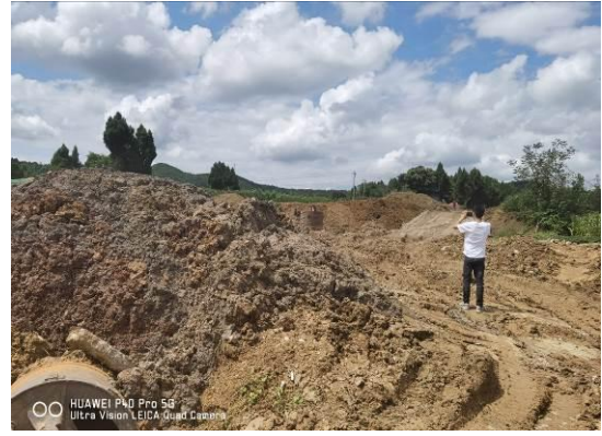
11 标段石碑哑大桥裸土未覆盖
