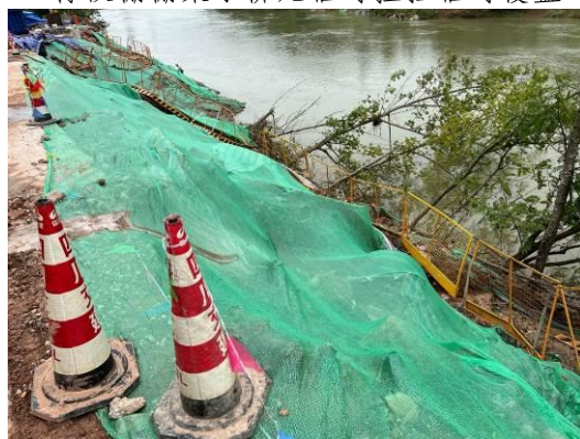
2 标段凯江大桥临河一侧施工未拦挡
