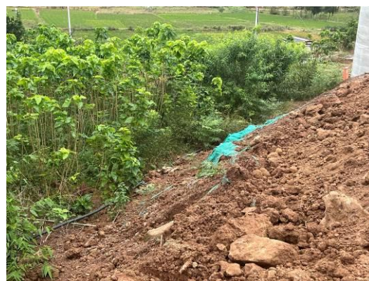
1 标段沙包咀大桥边坡无拦挡
