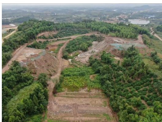
10 标段 7#渣场未修建挡墙和临时排水措施
