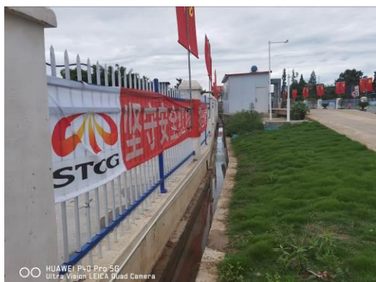
施工生产生活区排水沟
