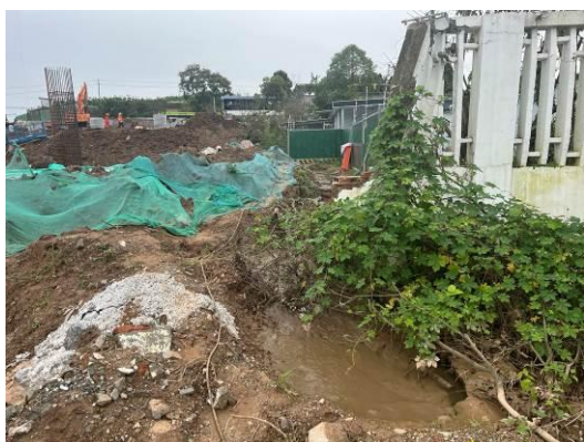
1 标段草堂村大桥裸土未及时覆盖
