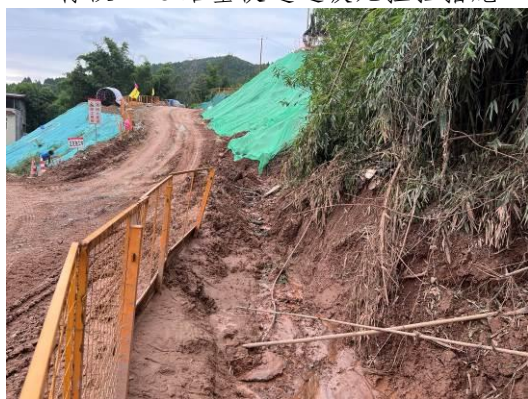
2 标段柏龙村大桥便道未修建临时排水沟
