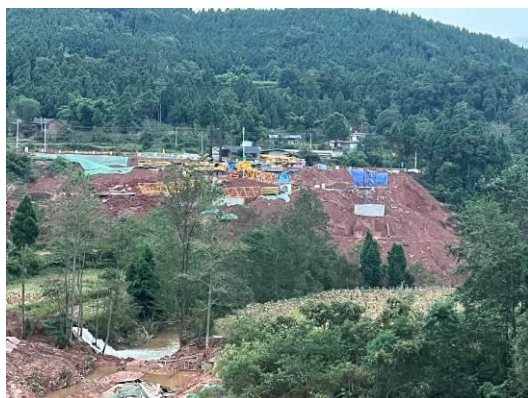
3-2 标段 K72-K73 路基边坡未覆盖
