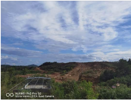
11 标段仙海互通裸土未覆盖
