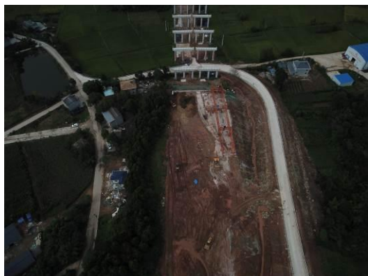
11 标段黄金河大桥裸土未覆盖
