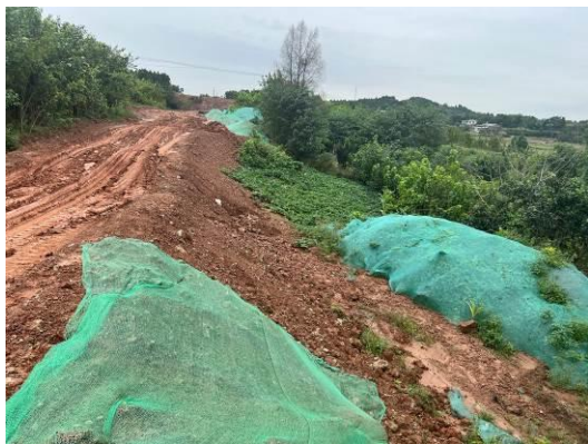
1 标段 K48 路基便道边坡无拦挡措施
