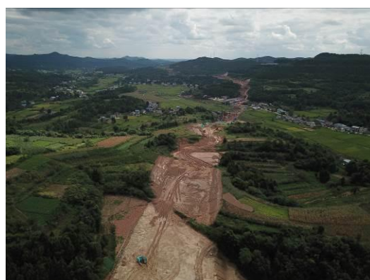
11 标段 k14+940 路基裸土未覆盖
