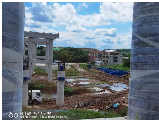
11 标段跨绵盐路大桥场地内无排水设施
