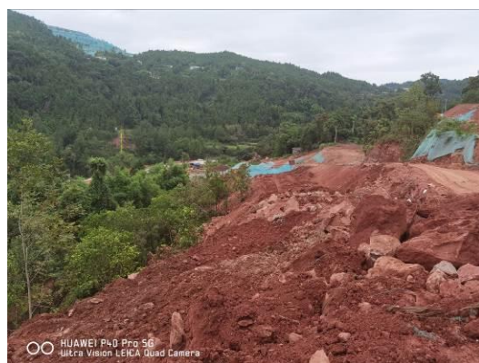
3-1 标段金竹沟大桥顺坡溜渣
