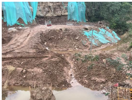
2 标段棚棚梁子桥无临时拦挡临时覆盖
