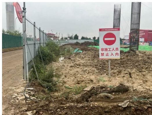
6 标段桥梁工程裸土未覆盖
