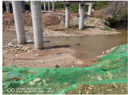
11 标周家堰大桥临河未拦挡
