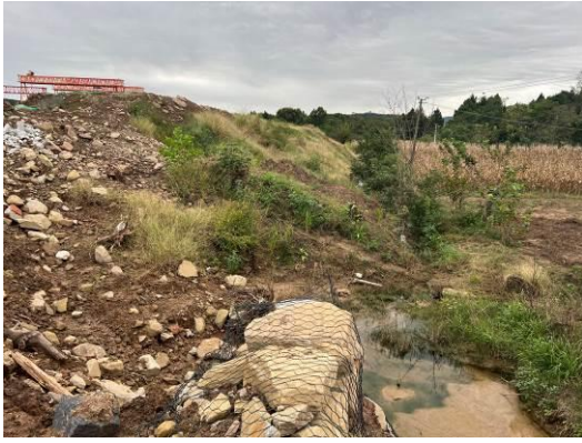
11 标段 1#弃渣场挡墙未修建完成
