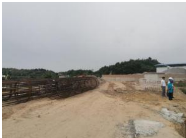
官地互通场内临时堆土未覆盖
