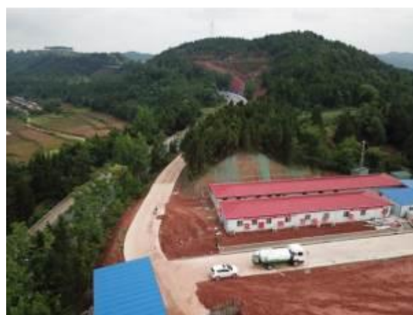
3-2 拌合站边坡未临时拦挡
