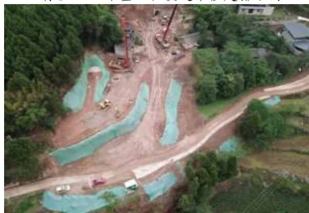
2 标段棚棚梁子桥便道未修建临时排水沟
