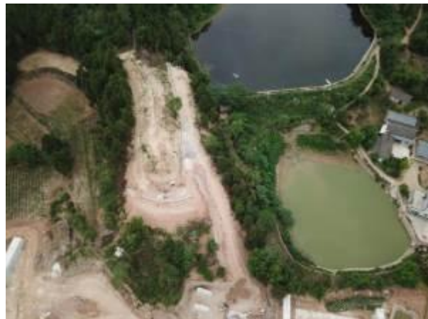
邓家湾大桥施工场地内边坡未设置拦挡措施
