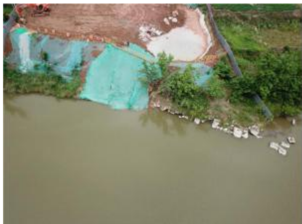
2 标段凯江大桥临河一侧未临时拦挡
