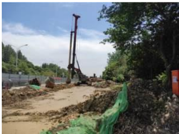
成青金高架三号桥施工区域内排水设施不齐全
