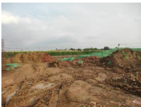
6 标北河 3 号特大桥临时堆土未覆盖
