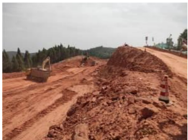
4 标弃渣场未修建挡墙、临时排水沟
