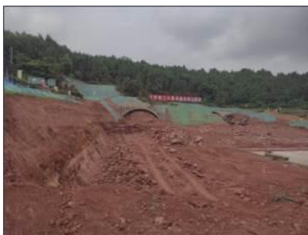
3 标段马鞍山隧道口未覆盖，无排水沟及沉沙池
