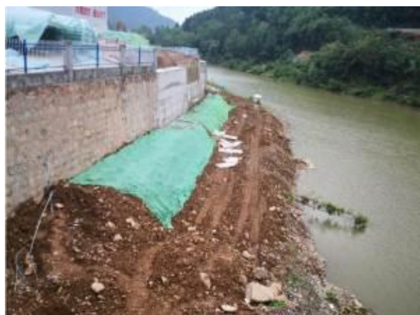
2 标段拌合站临河一侧未临时拦挡
