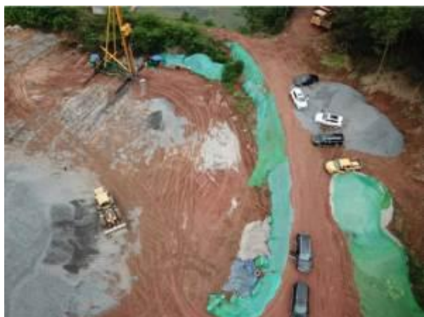
1 标段 K54 路基工程便道未修建排水沟
