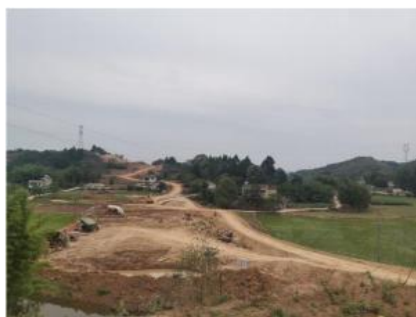
10 标段官地互通便道未修建临时排水沟
