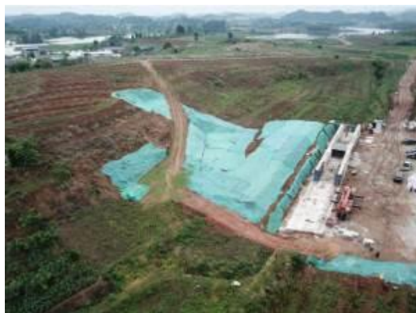
1 标段 K48 涵洞工程边坡未临时拦挡
