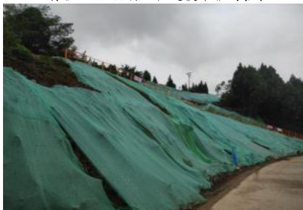
2 标段棚棚梁子桥道路边坡未临时拦挡
