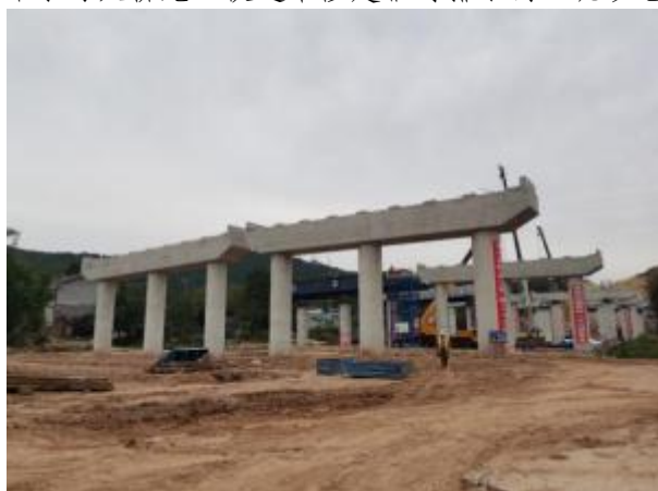
邓家湾大桥施工场地内临时堆土未覆盖
