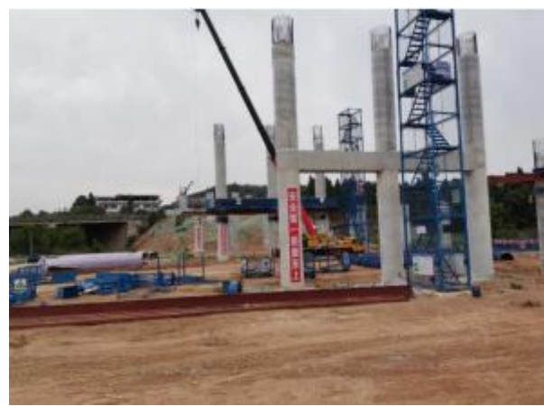
石碑娅大桥施工场地内未修建临时排水沟、沉砂池
