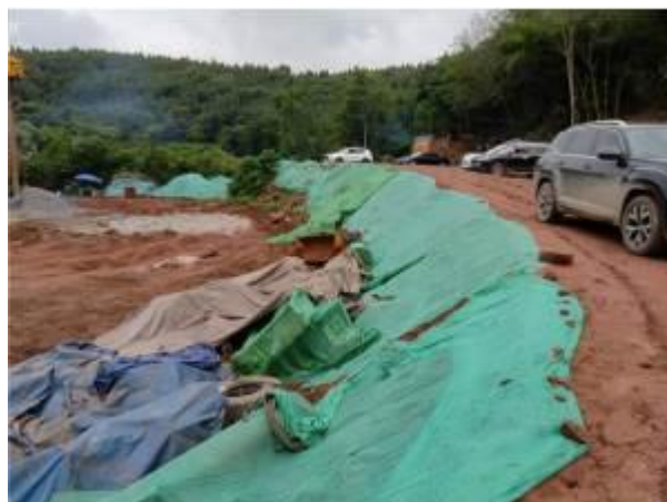
1 标段 K54 涵洞工程边坡未临时拦挡
