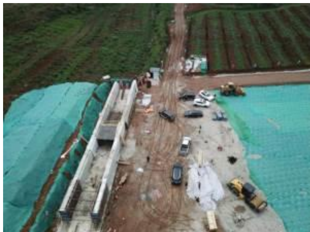
1 标段 K48 涵洞工程便道未修建排水沟
