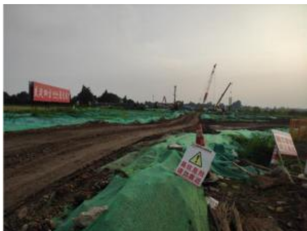
6 标段青江互通施工场内道路未修建排水沟和沉沙池
