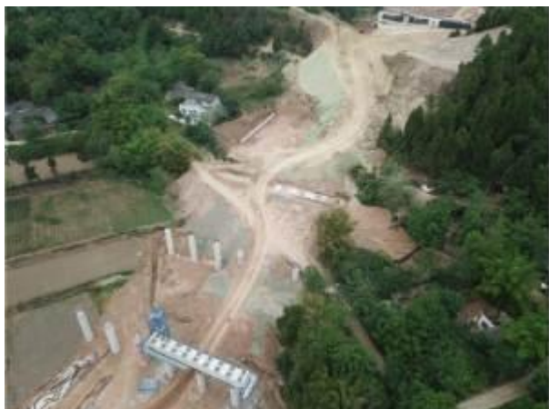
邓家湾大桥施工便道未修建临时排水沟、沉砂池
