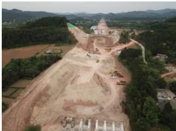
黄金河大桥施工场地内临时堆土未覆盖
