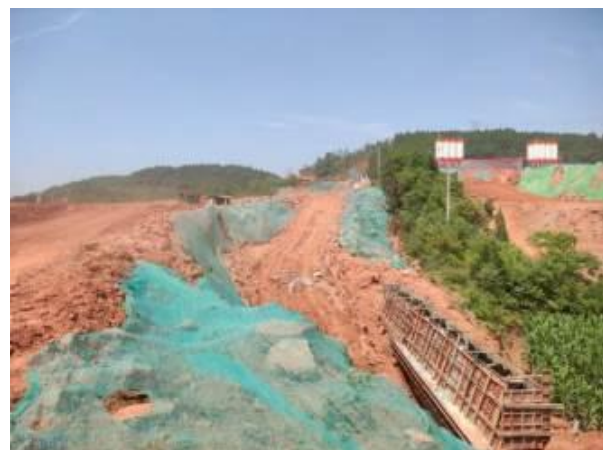
K97+600 路基便道未修建临时排水沟及沉沙池
