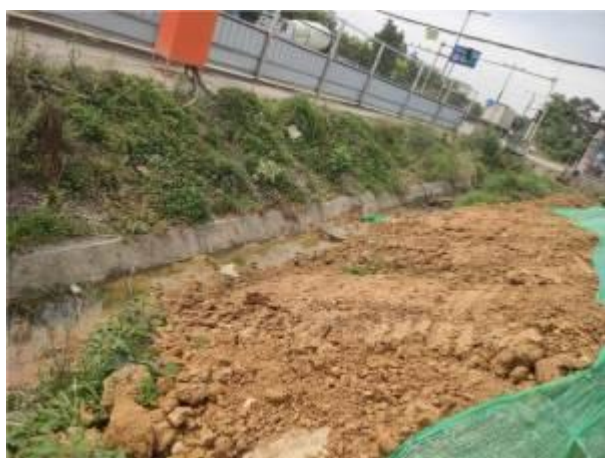
九号桥右场内堆土未临时拦挡
