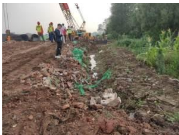
6 标北河 3 号特大桥便道未修建沉砂池
