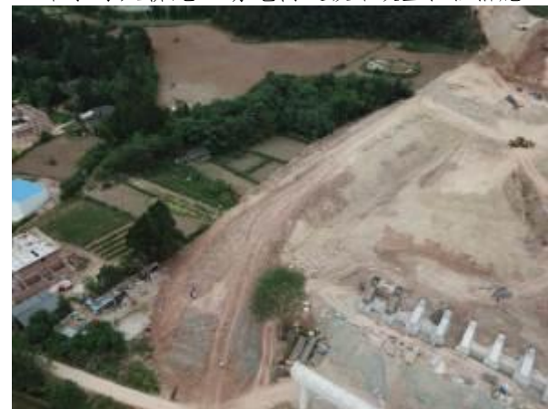
黄金河大桥施工便道未修建临时排水沟、沉砂池
