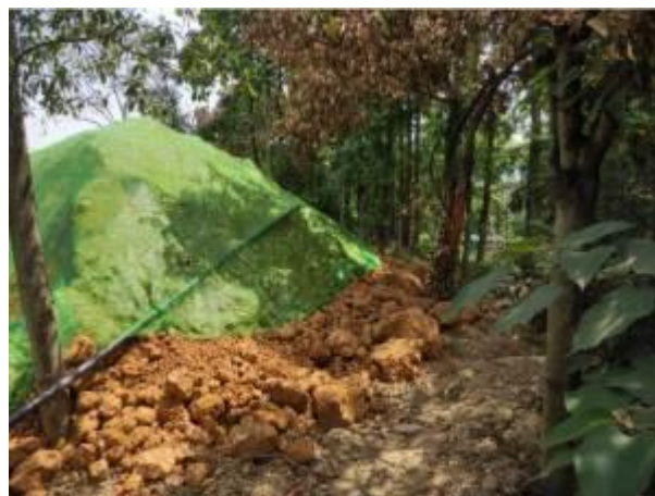
8 标段五环互通场内临时堆土未设置拦挡措施
